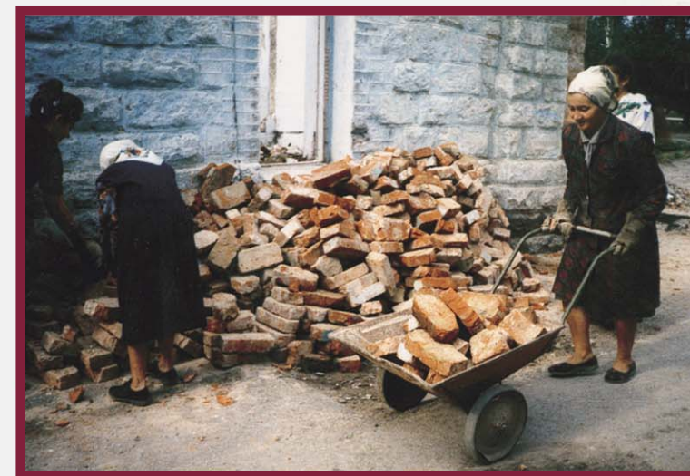
На стройке молитвенного дома общины МСЦ ЕХБ г. Каменец-Подольска весьма ошутим и этот усердный вклад!
