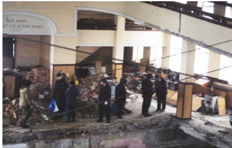
Внутри пострадавшего от взрыва здания по диагонали были натянуты восемь тросов, чтобы удерживать поврежденные стены.
